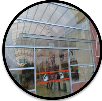
Puertas automáticas y vidrio templados
